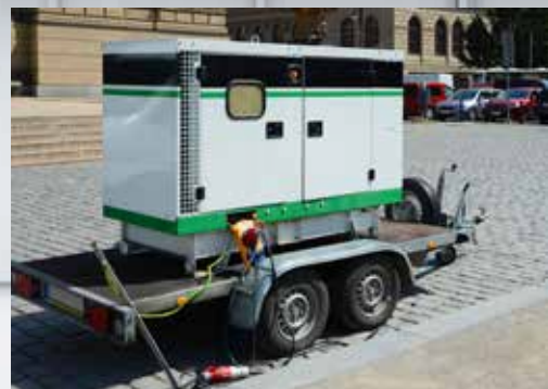
Generador diésel de emergencia Diesel generator for emergency power
