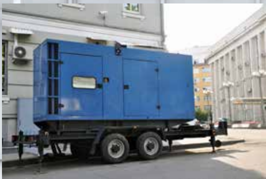
Generador de respaldo móvil diesel para edificios Mobile standby diesel generator for office buildings
