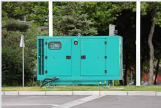
Generador estacionario para suministro de emergencia Stationary diesel generator for emergency power supply
